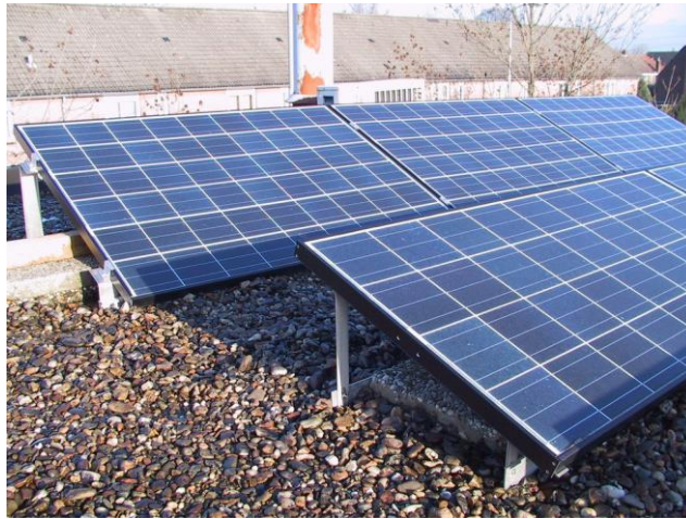
Afb. 5: rijen panelen die te dicht op elkaar staan
